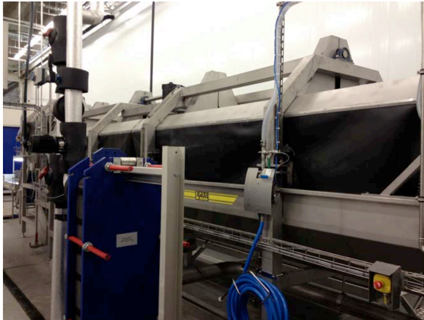
Maskinen med plattvärmväxlare ansluten.
